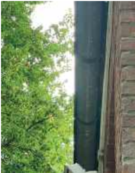
Die Löcher in der Dachrinne sind gut zu erkennen.
